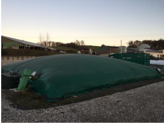
Figure 1 - Vue d'un digesteur de La Prade Biogaz
