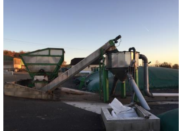
Figure 2 - Pré-cuve de mélange alimentée par une trémie et un convoyeur à vis sans fin - La Prade Biogaz
